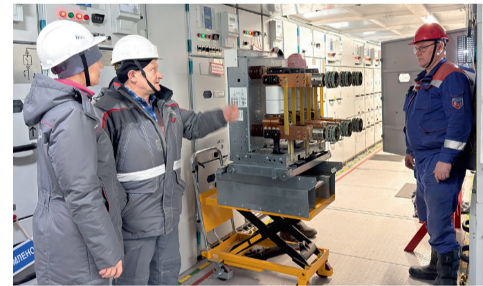
Работа по методу 5С на объектах энергоснабжения – комплексный и систематичный подход.
